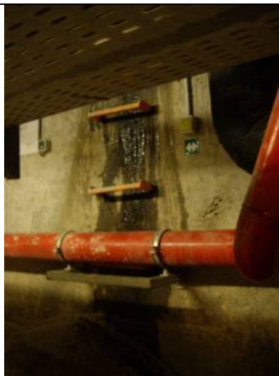
Acceso a salida dificultado por presencia de tubería.
