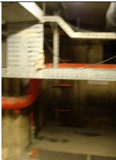
Acceso a salida dificultado por presencia de bandeja y tubería.
