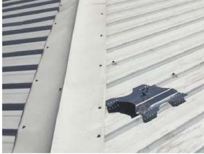
Fotografía 1. Anclaje estructural EN 795 A (punto antibalaneo)
