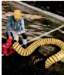
Ventilación general de un pozo de registro
