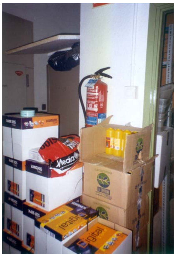
Figura 6. Acceso a extintor bloqueado
